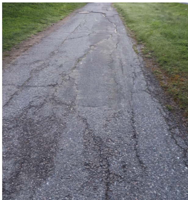
Huonokuntoinen jalankulku- ja pyöräilyväylä Tönnön mäessä.
