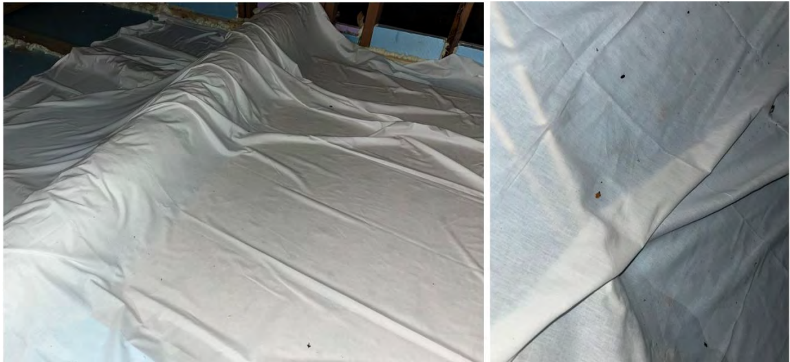
Kuva 4-10. Uutelan päärakennuksen ullakolle sijoitettu lakana elokuussa 2025.
