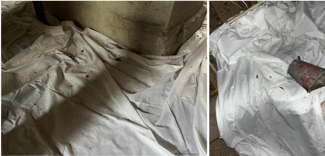
Kuva 4-12. Aittomäen pihapiirin mökin ullakolle sijoitetut lakanat elokuussa 2025. Lakanalla näkyvät pisteet ovat pääosin purua ja pölyä.
