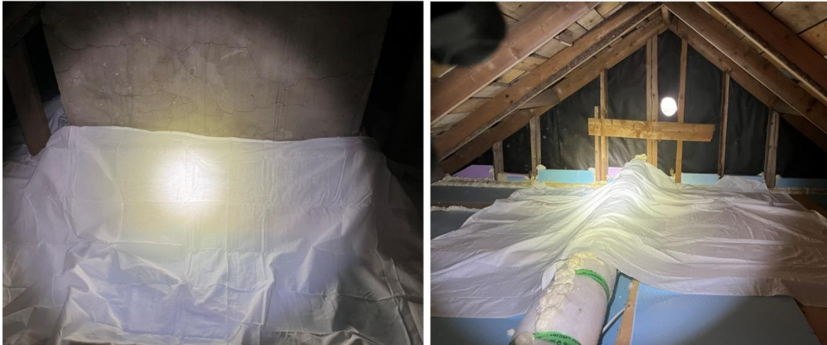
Kuva 4-6. Uutelan päärakennuksen ullakolle huhtikuussa 2025 levitetyt lakanat.
