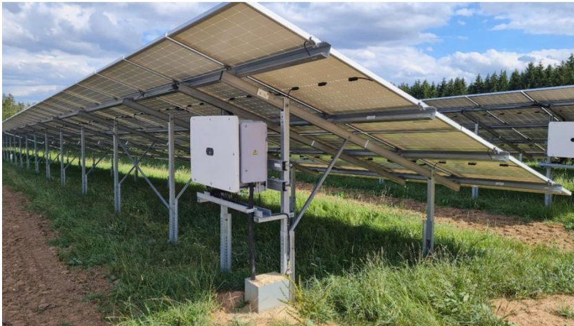
Kuva 5-3. Esimerkki aurinkopaneelien maanvaraisesta asennuksesta, jossa invertteri on asennettu aurinkopaneelipöydän alle rakennustelineisiin.
