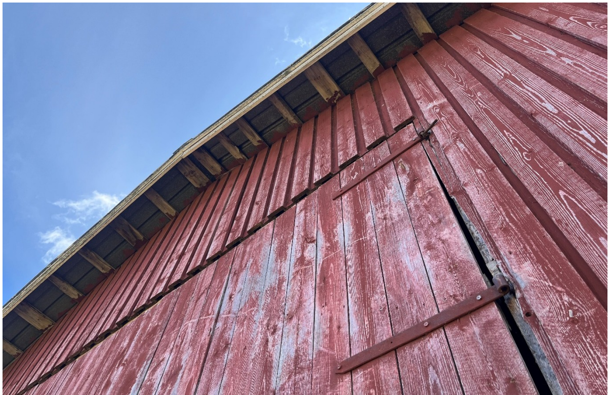
Kuva 2-6. Rakennuksen rakenteissa esiintyy rakoja, jotka mahdollistavat lepakoiden liikkumisen rakennukseen ja sieltä ulos.
