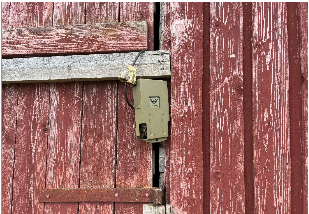
Kuva 2-5. Rakennuksen ulkopuolelle asennettu nauhoittava detektori.
